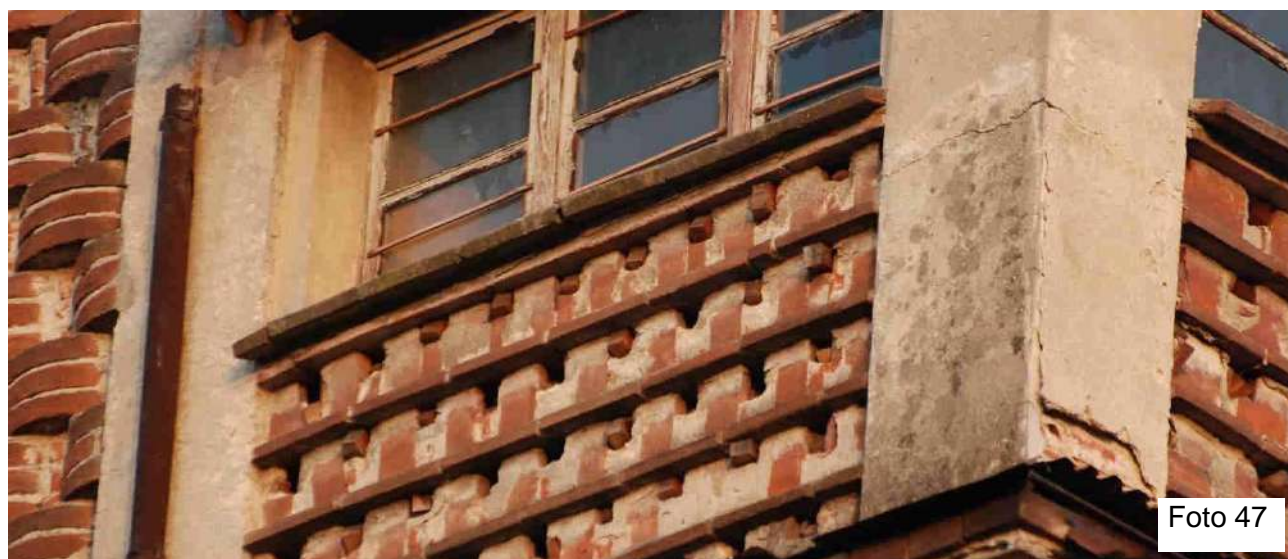
Foto 47 – Rondonara in vecchia villa patrizia. Alcuni accessi sono stati chiusi ma altri sono attivi.
