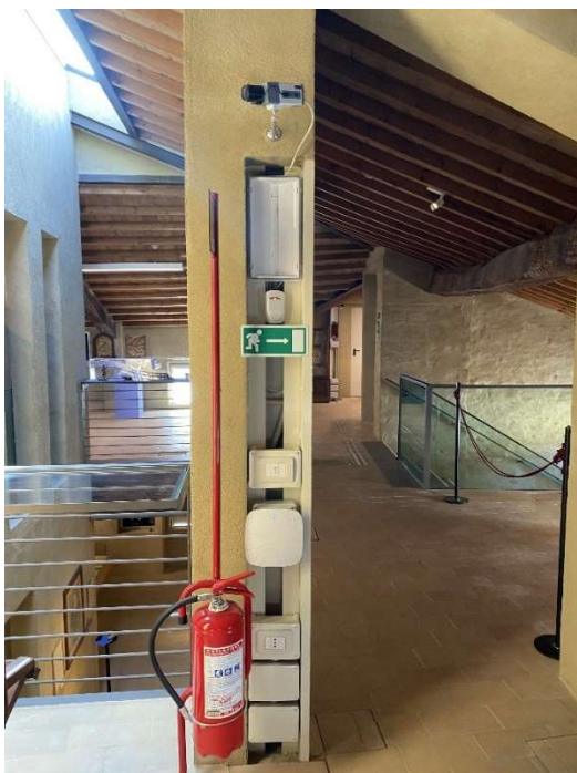
Figura 20: segnalazione di emergenza al secondo piano
