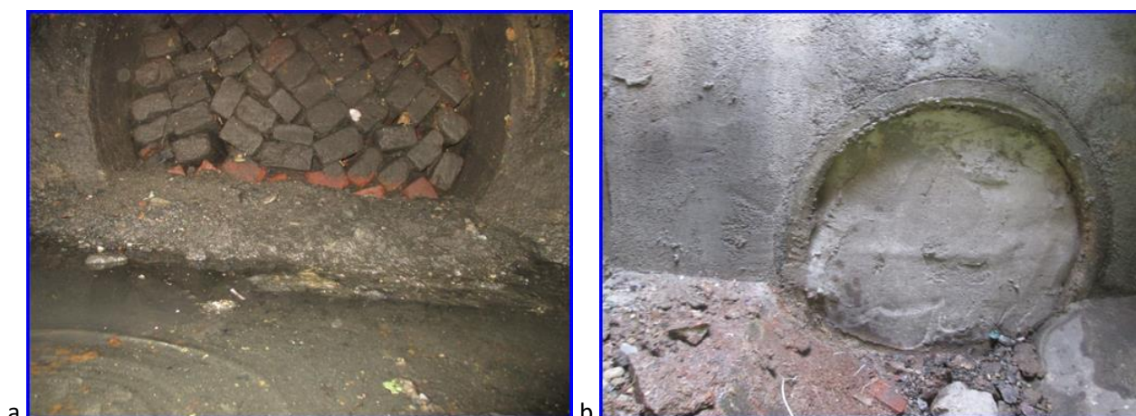
Figura 13: a) tubazione murata in cameretta n°178, b) tubazione murata in cameretta n°991
