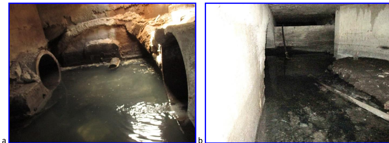
Figura 9: a) vista tubazione in entrata in cameretta n°1341 b) terminale cunicolo attraversamento Vigevanese
