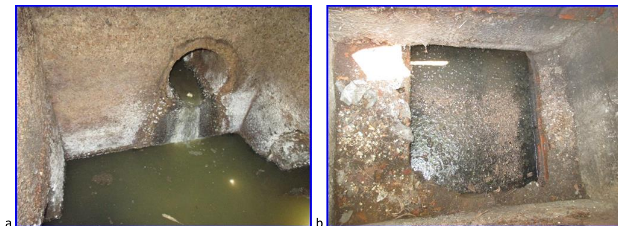
Figura 16: a) innesto libero in cameretta n°645 di via Roma, b) reflui in cameretta n°643 di via Tommaseo
