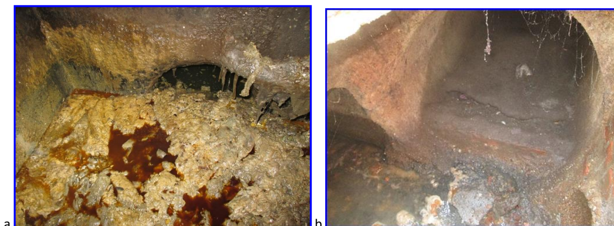
Figura 11: a) intasamento nella cameretta n°35 di via Vespucci, b) soglia nella cameretta n°1192 di via Roma.
