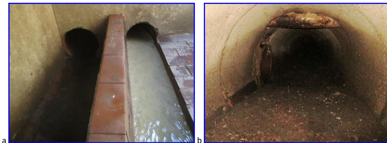
Figura 18: a) partizione n°767 di via Cavour, b) vista tubazione di monte camera n°1332.
