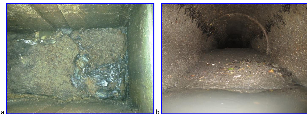
Figura 12: a) vista cameretta n°1129 di via Roma, b) vista tubazione in disuso camera n°204.
