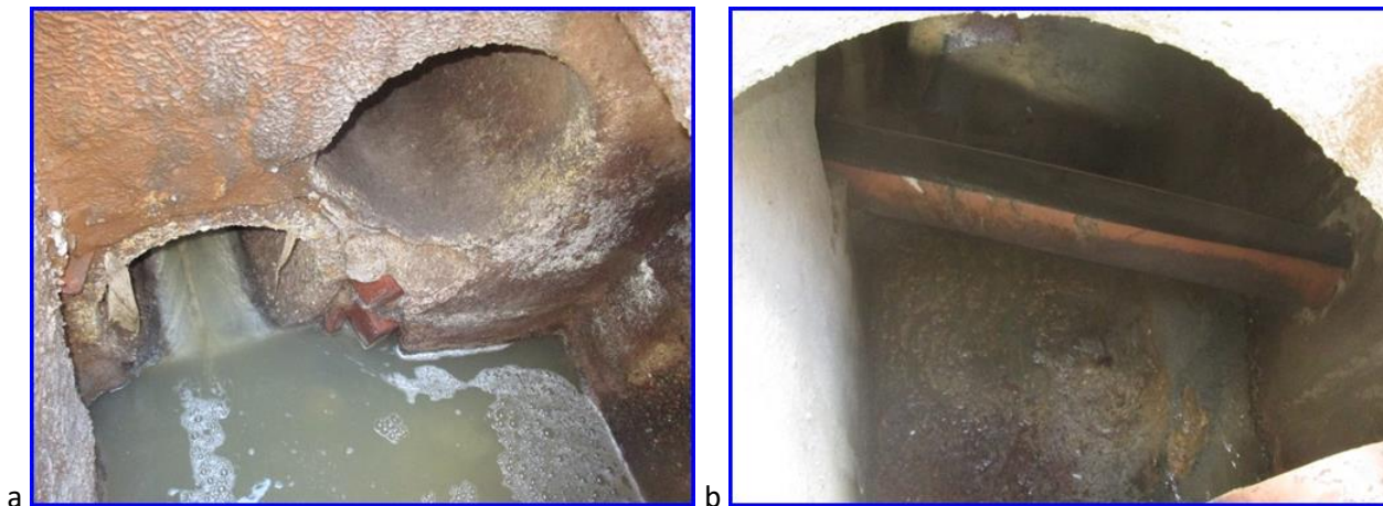
Figura 17: a) partizione n°572 di Via Pasubio, b) partizione n°738 di Via Grandi.
