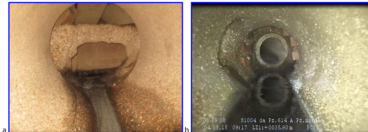
Figura 10: a) vista tubazione in entrata in cameretta n°1341, b) vista tubazione in entrata in cameretta n°1685.
