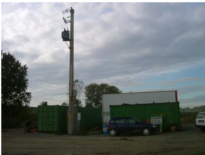
Foto 2: cabina di trasformazione su palo
