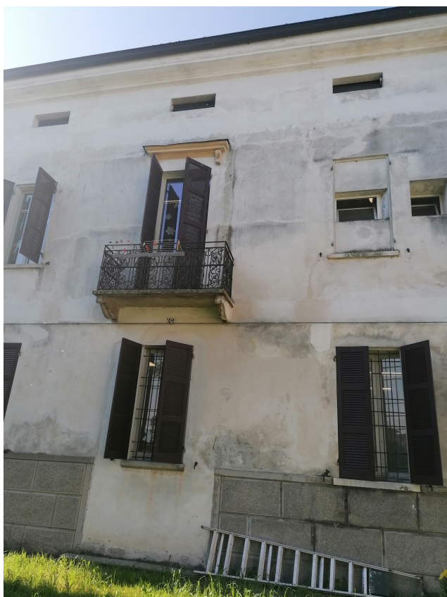
5. Vista del prospetto est con i serramenti in corrispondenza dei servizi igienici.
