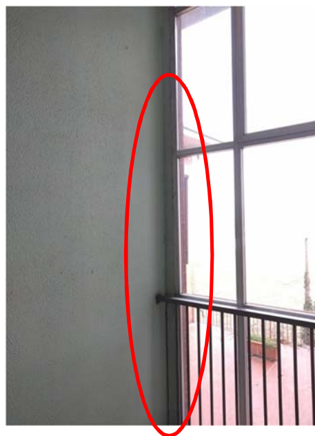
Fessurazione angolo vano scala
