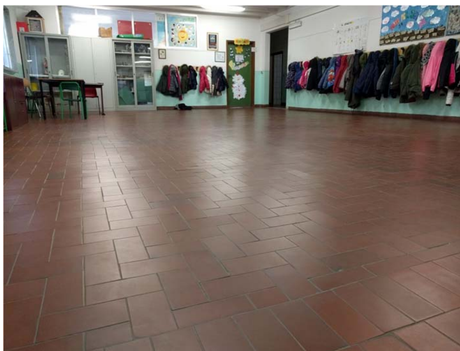
Irregolarità della pavimentazione
