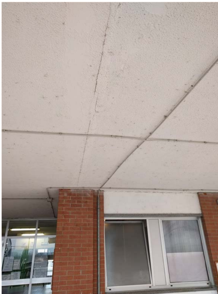
Fessurazione su solaio sovrastante il porticato
